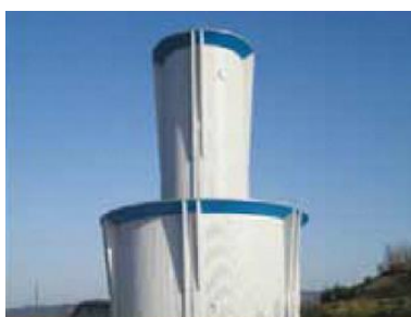
木津中央配水池 有効容量高区 764㎡×1池 低区 3,882㎡×1池
