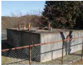
高去配水池 有効容量 36.9㎡×2池
