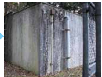
法花寺野配水池 有効容量25.5㎡×2池
