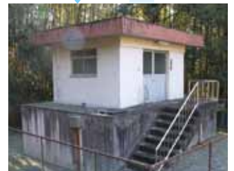
辻配水池 有効容量 35.2㎡×2池
