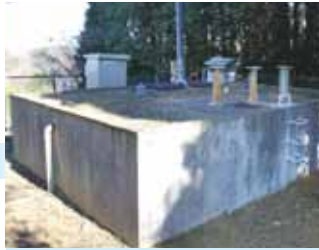
大畑配水池 有効容量 21.6㎡×2池
