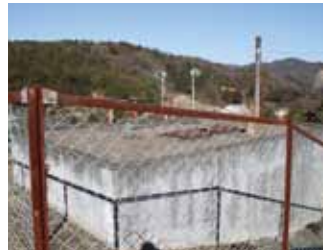
山田配水池 有効容量 24.3㎡×2池
