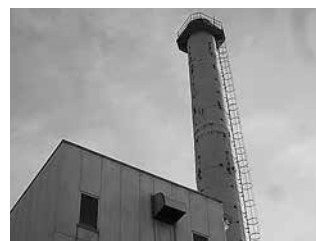
老朽化が進む煙突
