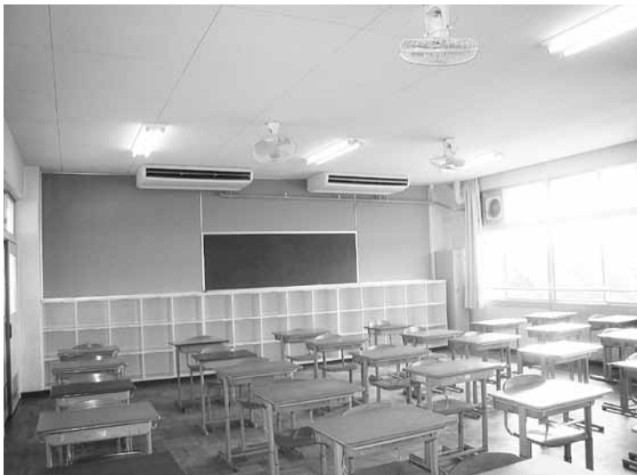
幼稚園・小中学校の空調設備
