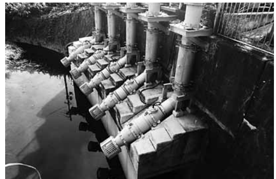
木津合同樋門の排水ポンプ
