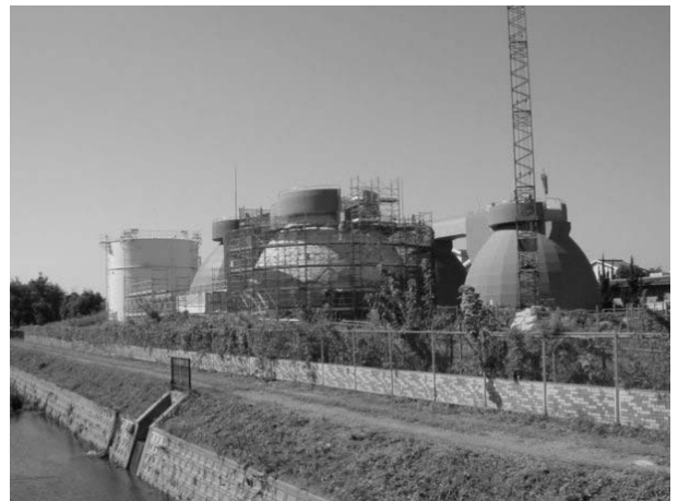
京都府木津川上流浄化センター（汚泥消化タンク）
