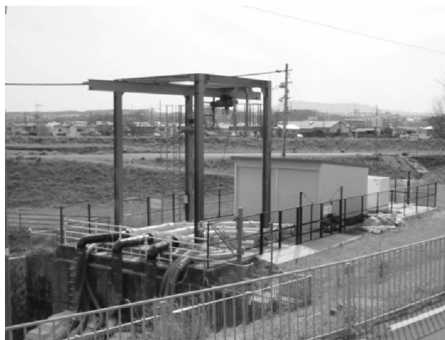
木津合同樋門の排水ポンプ設備
