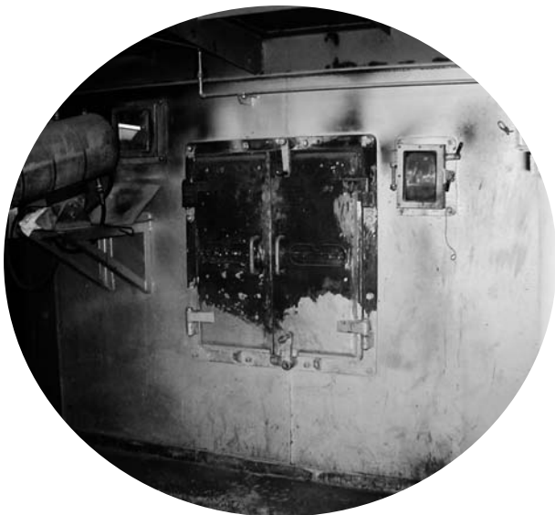
打越台環境センターの内部
