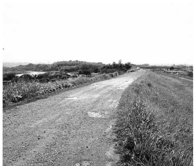
堤防強化が急がれる砂でできた木津川の堤防
