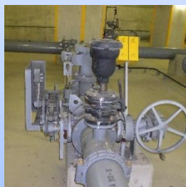
緊急遮断弁（木津南配水池）
