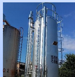
活性炭ろ過機（船屋浄水場）
