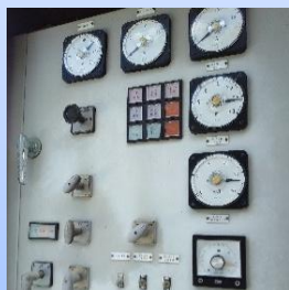
制御盤（法花寺野加圧ポンプ所）
