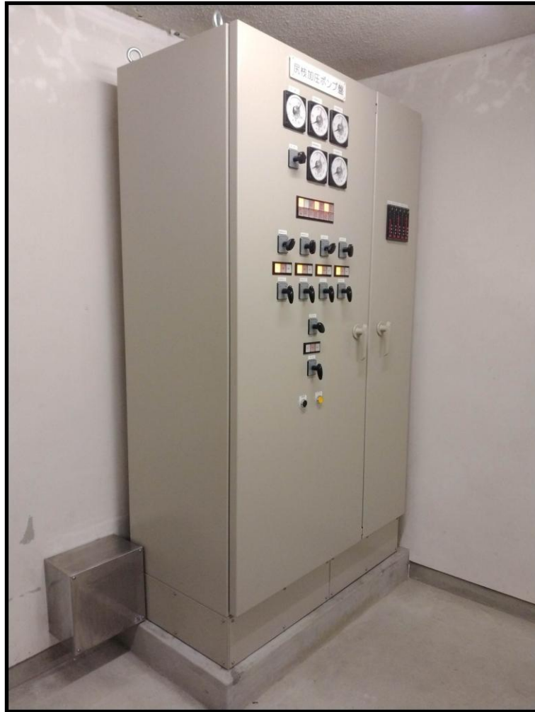
尻枝加圧ポンプ場制御盤 令和7年度更新
