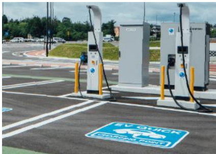
EV 充電スタンド 道の駅西条のん太の酒蔵
