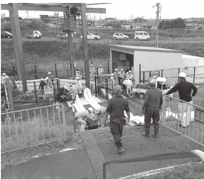
台風シーズンまでに間に合わせたい排水ポンプ（木津合同樋門）
