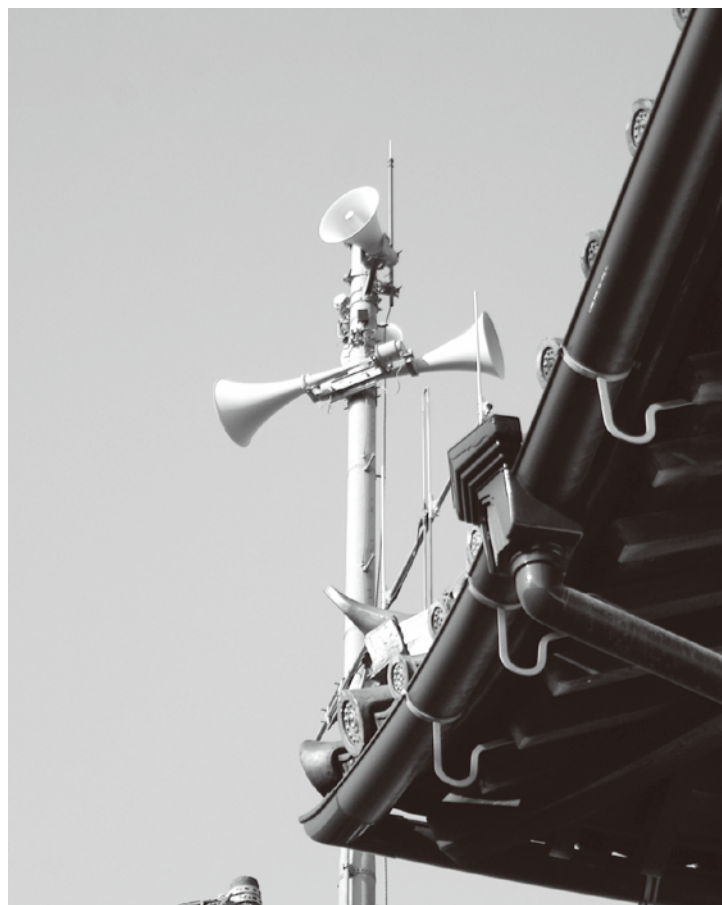
防災行政無線を全市域に整備（屋外拡声式受信装置）
