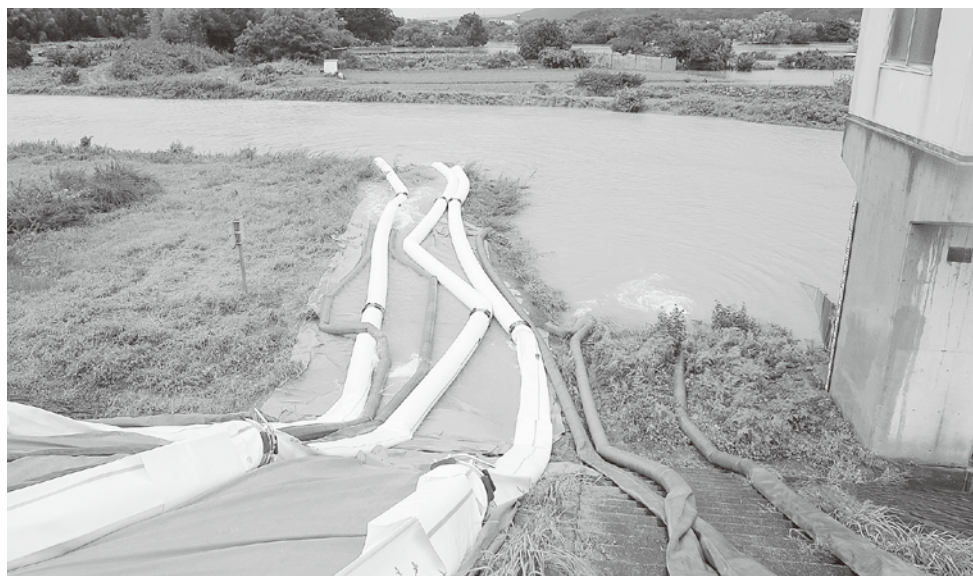
台風18号で初稼動の合同樋門の排水ポンプ
