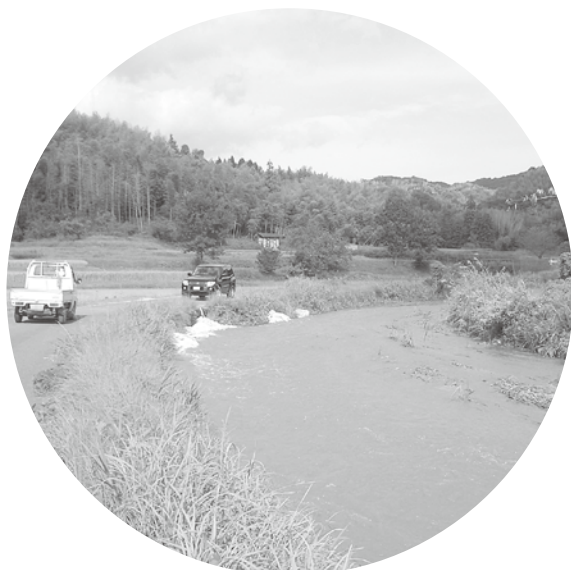
台風被害が出た鳴子川上流の堤防
