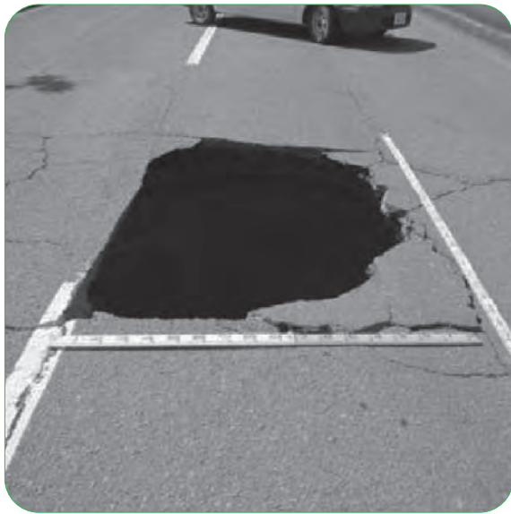
福知山市で発生した下水道管が起因の道路陥没
