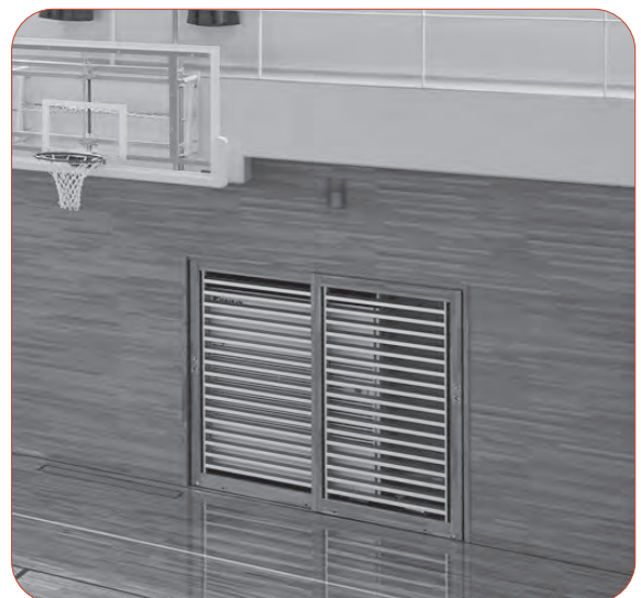
市内小学校で唯一空調設備があるひだまりホール（城山台小学校第2体育館）
