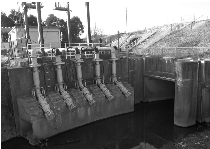
現在の小川内水排除設備（毎分160m 3 ）
