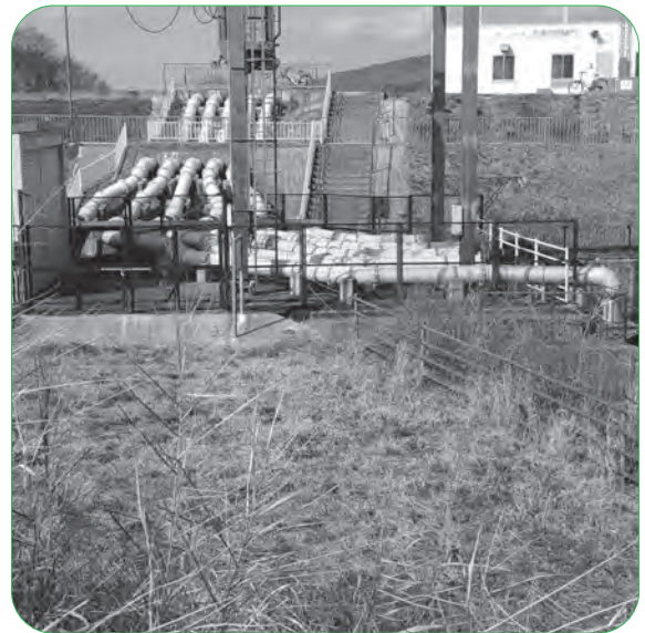
更に強化される排水ポンプ施設（現在の木津合同樋門）
