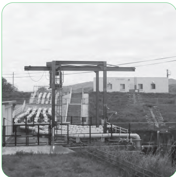
強化が待たれる排水ポンプ（木津合同樋門）
