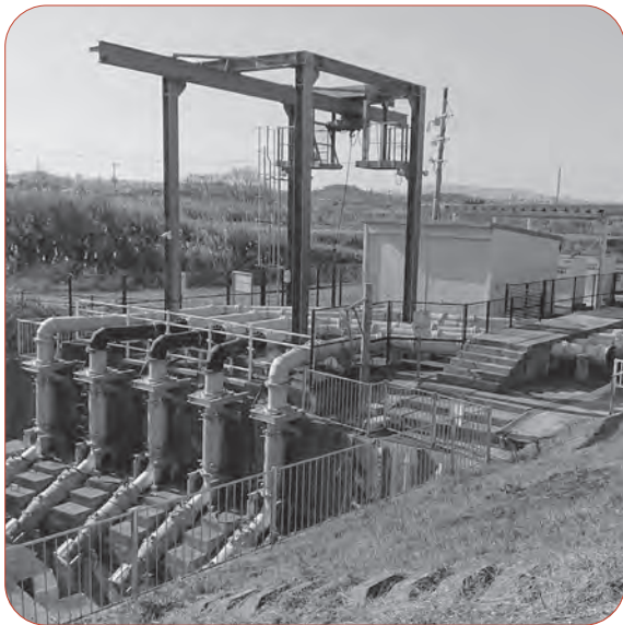
さらなる強化が必要 (木津合同樋門)
