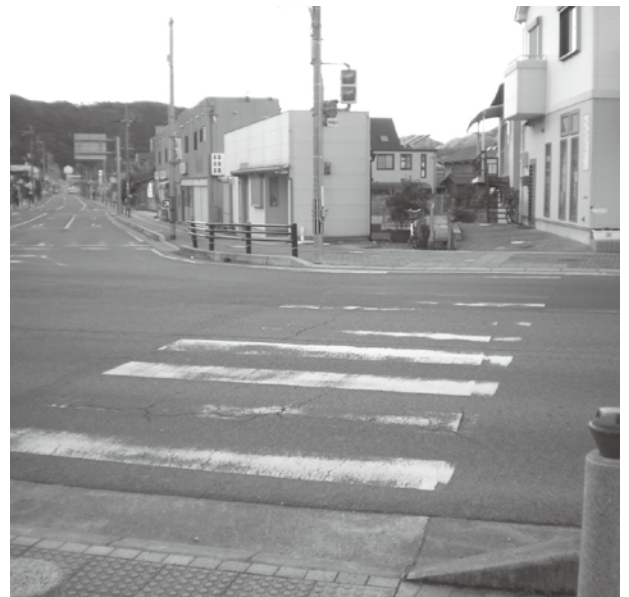
路面表示の薄れた府道（JR加茂駅前）
