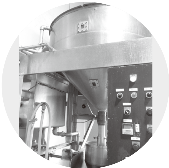
更新が必要な厨房機器（山城学校給食センター）
