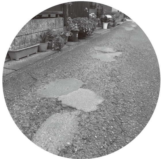
傷んでいる生活道路
