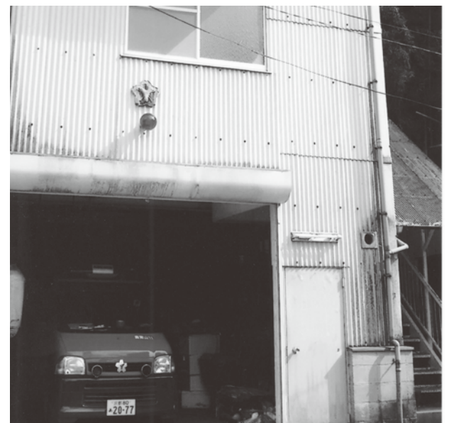
耐震診断が待たれる消防団詰所
