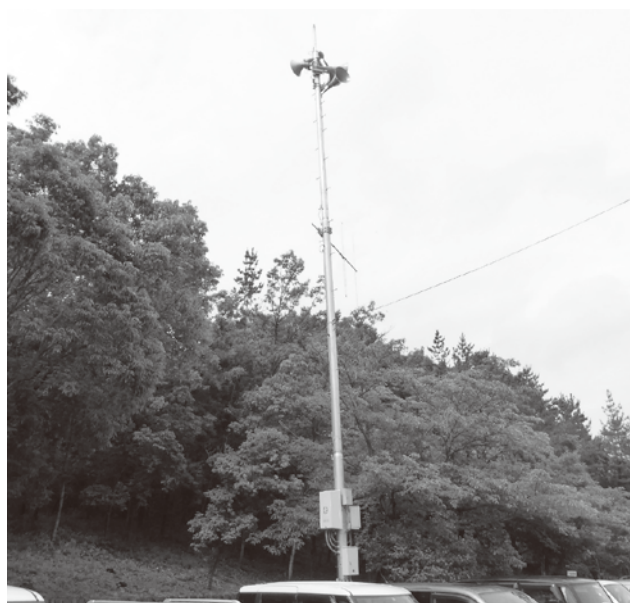
防災行政無線テスト放送は改善が必要(兜谷公園)
