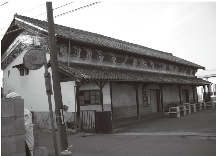
環の拠点施設として活用が困難になったJA山城倉庫
