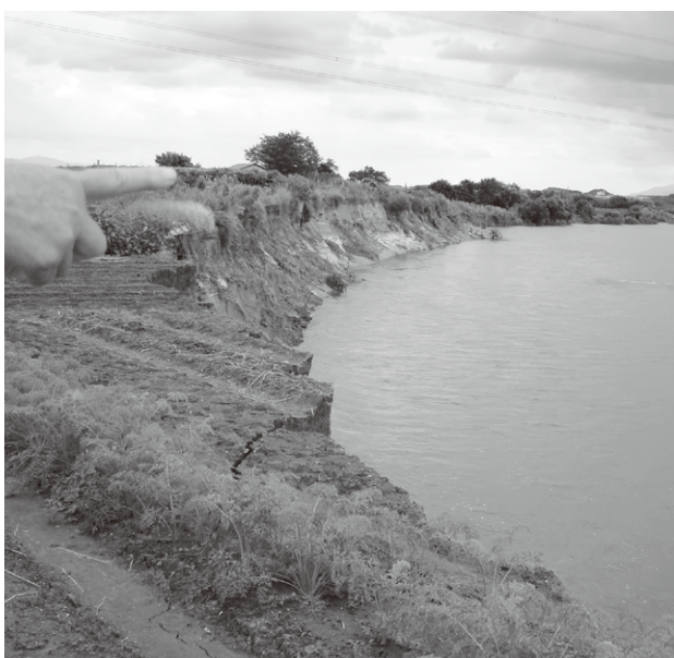
山城町大川樋門付近の農地浸食
