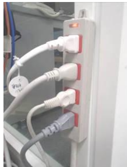
非常用電源コンセント
