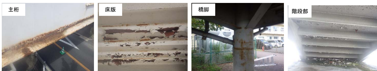
各主部材のⅡ判定損傷
