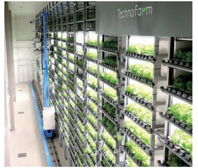
天井近くまで栽培棚が。スタッカークレーンがレタスを棚パネルごと収穫する。
