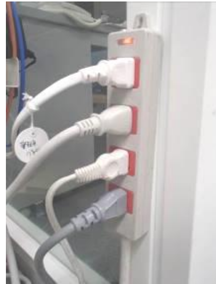
非常用電源コンセント
